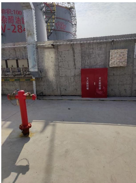
罐区消防栓、灭火器
