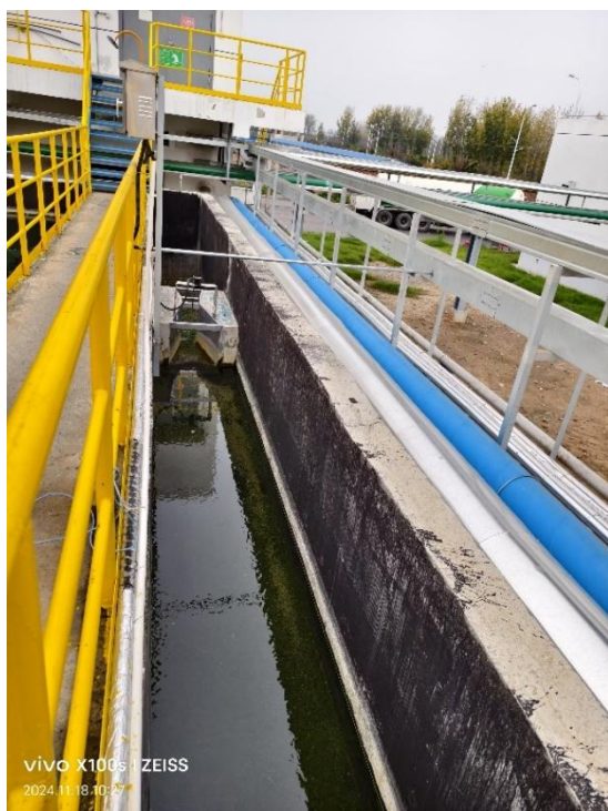
厂区废水总排口 DW009
