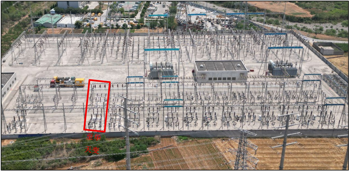
图 4-3 秋山变电站出线间隔实景图
