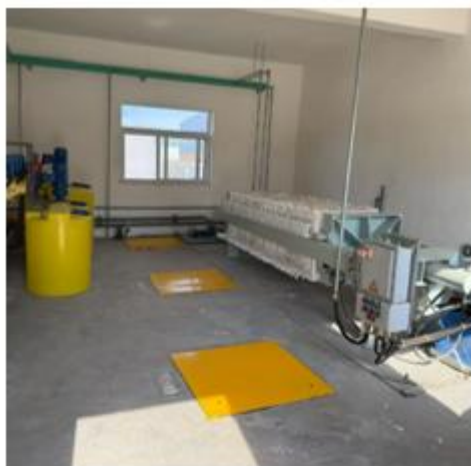
污水处理站（地下式）
