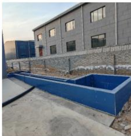
污水处理站总排口
