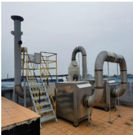
工艺废气末端处理系统及排气筒
