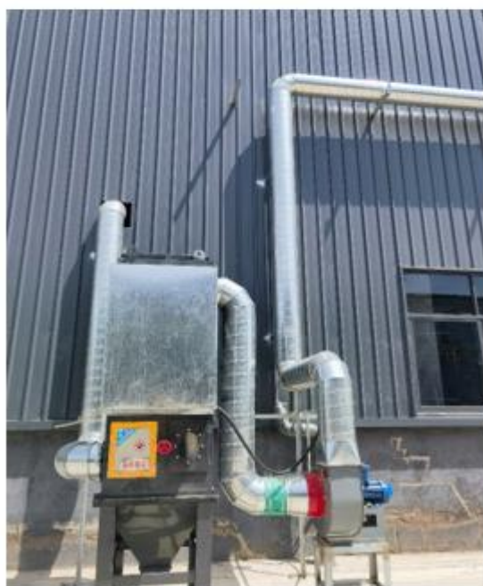
固体物料投料粉尘布袋除尘器
