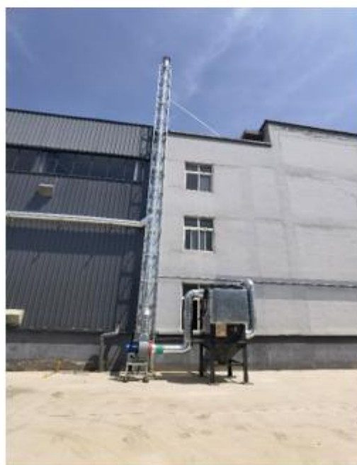
粉碎包装粉尘布袋除尘器及排气筒
