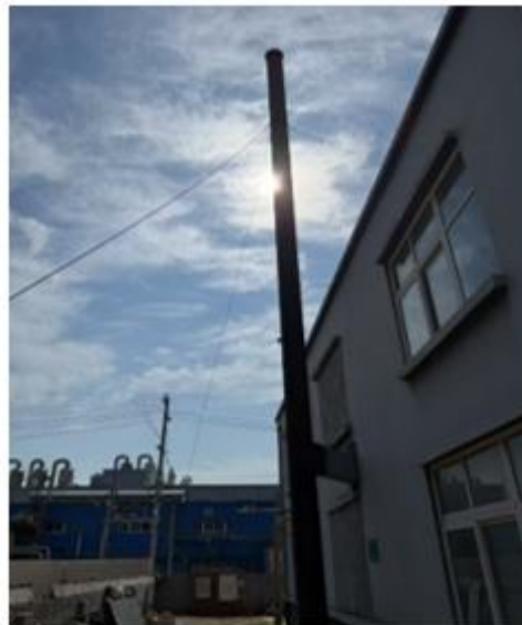
燃气锅炉排气筒
