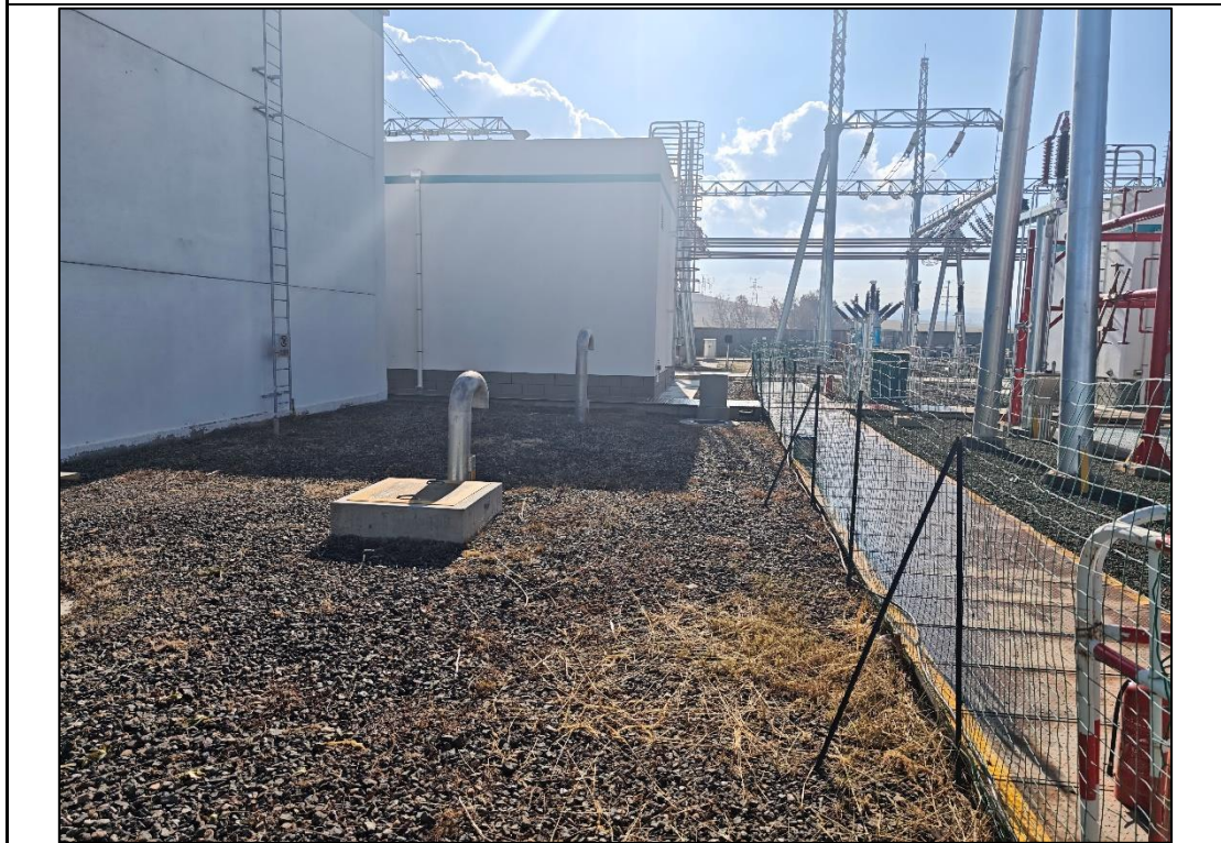
事故油池（地下）
